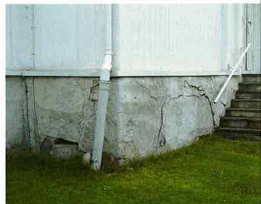
Her ser man tydelige skader på grunnmuren under nordre korsarm.
