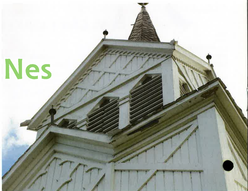
I tårnet er det oppstått råteskader pga lekkasjer.
