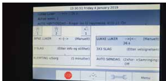
Nytt og moderne ringeanlegg, med lukeåpnere
